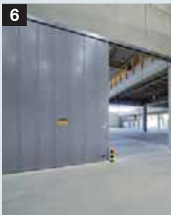
6 Protipožární posuvná vrata
