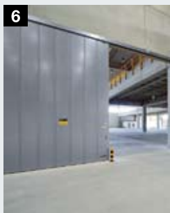
6 Protipožární posuvná vrata
